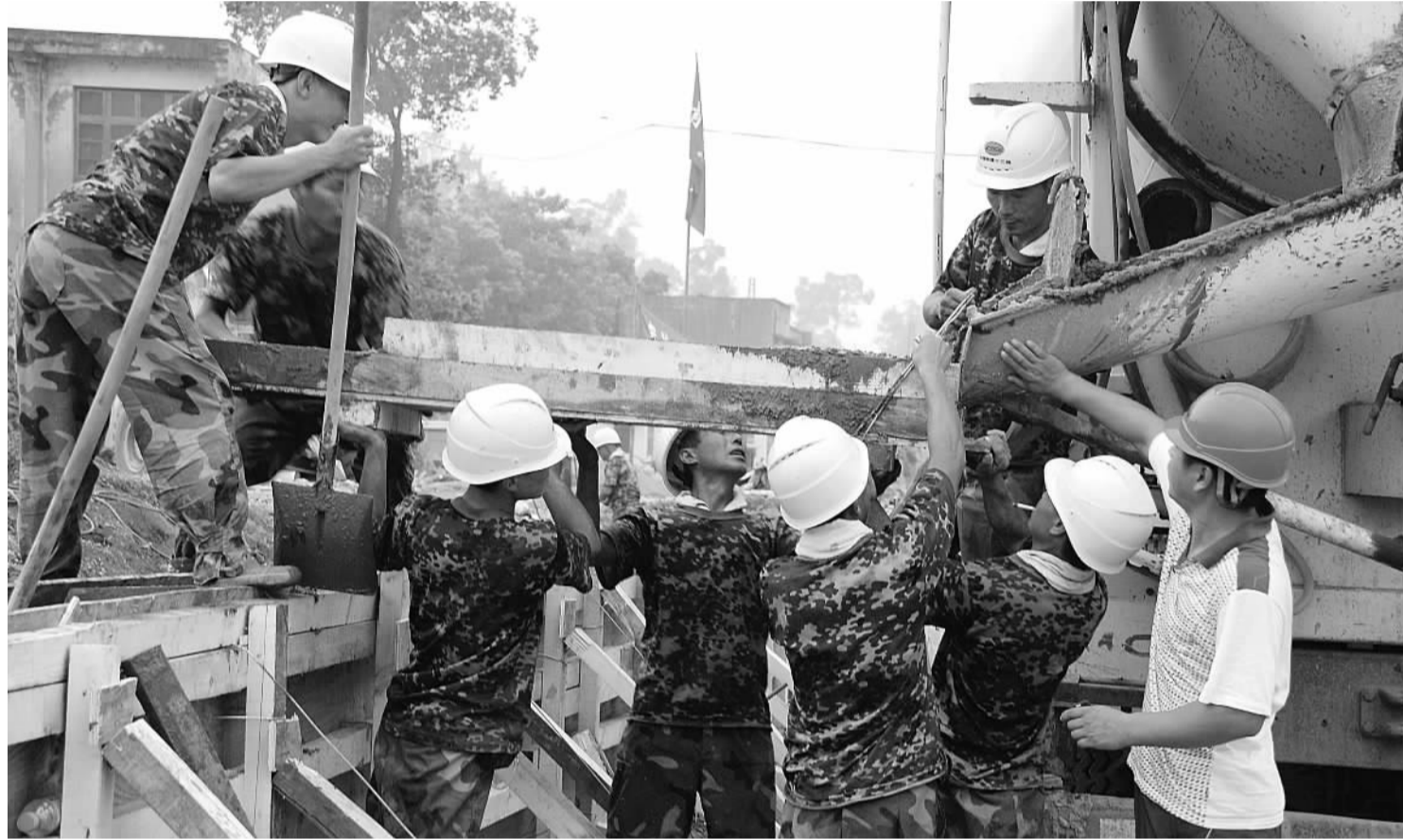
随着铁道部8月30日必须通车的指令下达,承建襄渝铁路二线ZH-7标的十三局集团三公司迎来了最后攻坚阶段。公司董事长兼总经理周长斌、党委书记王家福坐镇襄渝,全面指导施工。公司组建了4支青年突击队,24小时倒班作业,青年突击队队旗高高飘扬,“襄渝铁路会战必胜”的横幅醒目。 杨德伟 摄
