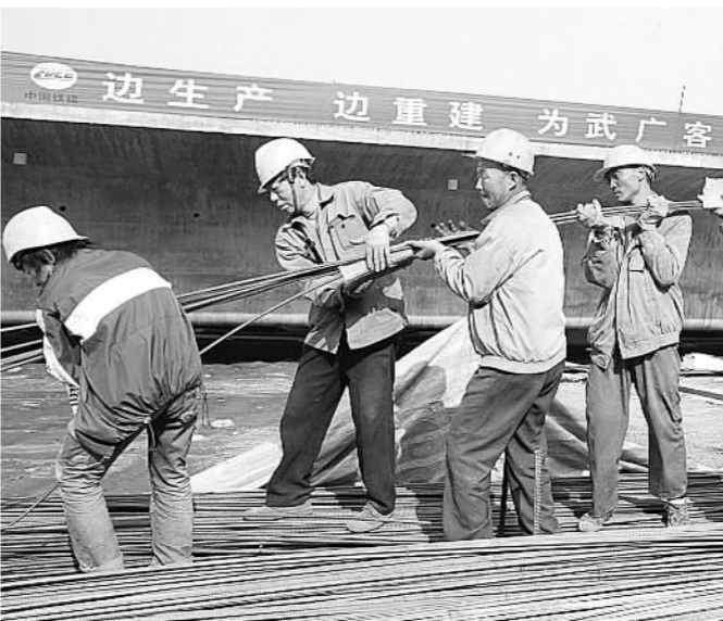
担负广客专三线Ⅲ标段施工任务的十六局集团五公司为夺取救灾重建全面胜利,迅速组织掀起百日施工大干高潮。左图为齐心协力,施工大干。右图为绑扎900吨混凝土箱梁钢筋。
