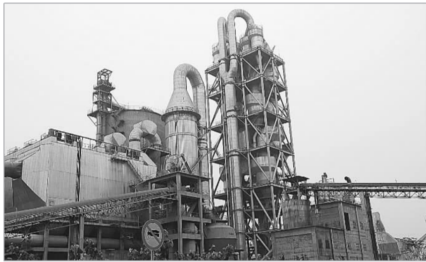
安徽白马海螺水泥厂烟气回收系统
