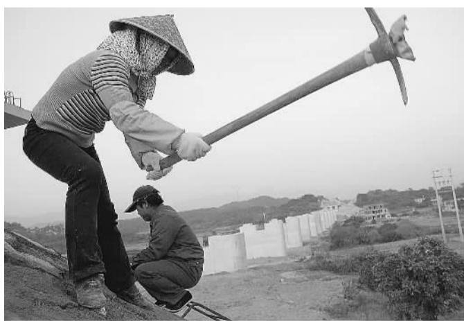
福厦铁路客运专线途经泉州市惠安县,素以吃苦耐劳而著称的惠安女纷纷走出家门,和职工一起奋战在铁路施工一线,谱写出工农共建铁路的和谐景象。图为一名惠安女在福厦客运专线与二十一局集团职工一起施工。 柳武平 摄
